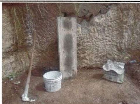
Foto 3: La calda de aguas y la tapadera de sanitarios solo es de tabla, se esta construyendo de concreto (tapadera y su base de concreto)
