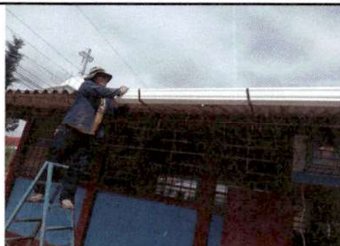
Foto 5: El canal de este modulo, estaba en malas condiciones, por lo que se estan cambiando.
